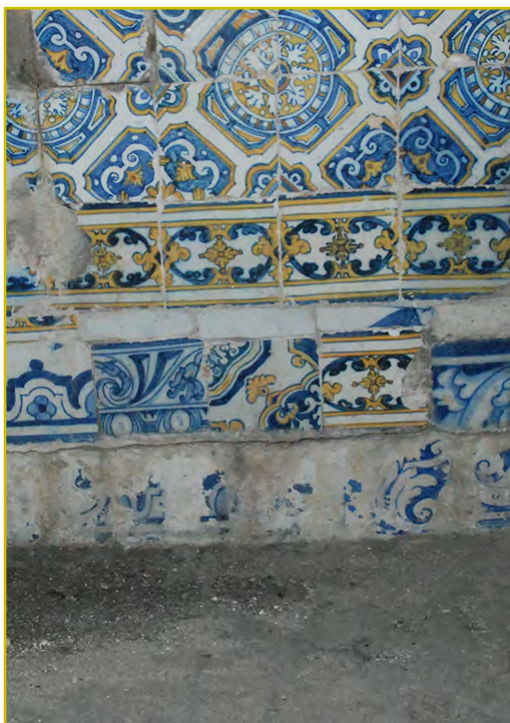
Figura 15 Quarto momento do revestimento azulejar: após a descoberta do pavimento em pedra original, este foi destapado e o espaço entre o pavimento e os azulejos preenchido com azulejos de várias épocas. Este momento pode ser datado de entre os finais do século XIX até ao primeiro quartel do século XX. Fotografia do autor, 28-11-2013.
