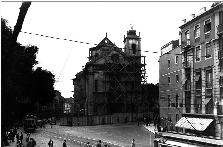
Figura 2 Igreja de Nossa Senhora do Socorro em processo de demolição, Eduardo Portugal. AML, PT/AMLSB/POR/019588.
