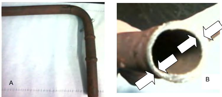
Fig. 1- Aspecto geral da zona do joelho (A) e pormenor da secção recta do tubo junto da mesma zona, podendo-se ver claramente a redução da parede na parte interior da curva do tubo (B).
