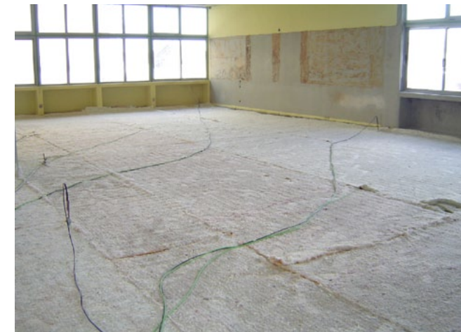
Fig. 3- Ligações às armaduras (catódicas) e à malha de aço (anódicas).
