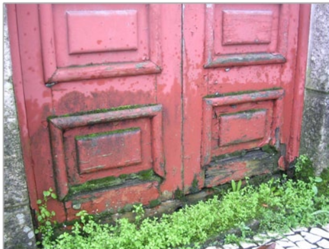
Fig. 6 - Detalhe da maior degradação da parte inferior de uma porta pintada.
