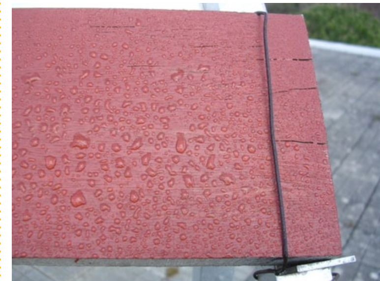
Fig. 21 - Solução de proteção com repelentes à água.
