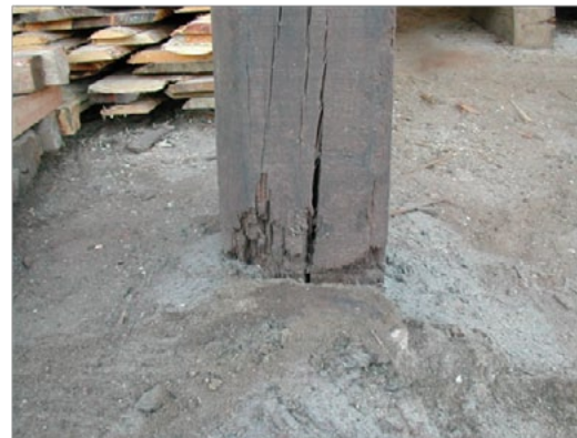
Fig. 8 - Efeito da degradação biológica (podridão) num pilar de madeira enterrado no chão.
