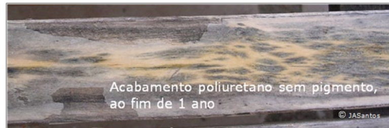
Fig. 3 - Degradação da superfície com um revestimento de película transparente.
