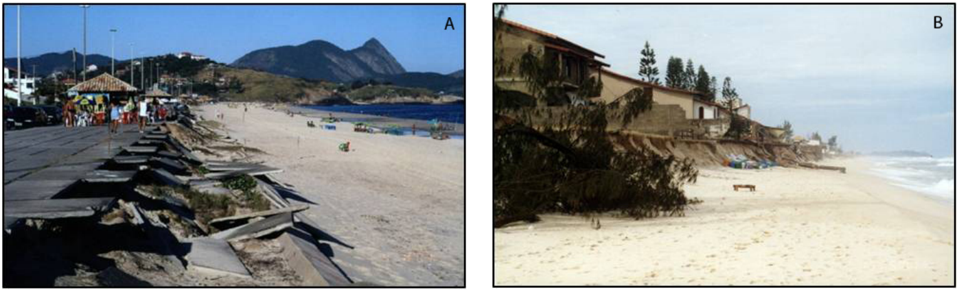
Figura 4. Destruição de muro na praia de Piratininga em Niterói (A) e casas na orla da Barra de Maricá (B) após ressaca de maio de 2001. Figure 4. Collapse of a sea-wall at Piratininga Beach in Niterói (A) and destruction of houses in Barra de Maricá (B) after the storm of May 2001.
