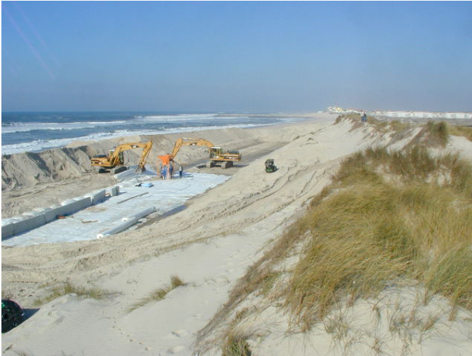
a) Instalação de mantas de material geotêxtil, em 11 de fevereiro de 2005. a) Installation of geotextile wraps on February 11, 2005.
