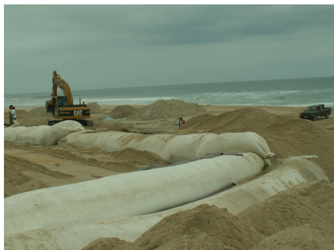
b) Instalação de tubos pré-fabricados em material geotêxtil em 22 de julho de 2008.
