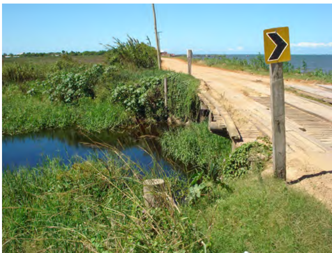
Figura 4 - Ponte de acesso à Colônia de Pescadores Z3, sobre o canal Reasilva. Detalhe para o aterro consolidado para a construção da estrada e que secciona a conexão natural existente entre as áreas de banhado (à esquerda) e a Laguna dos Patos (à direita). Fonte: Delamare
