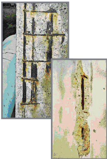
Fig. 2 – Estrutura em betão armado com sinais visíveis de corrosão (Adaptado de [9]).
